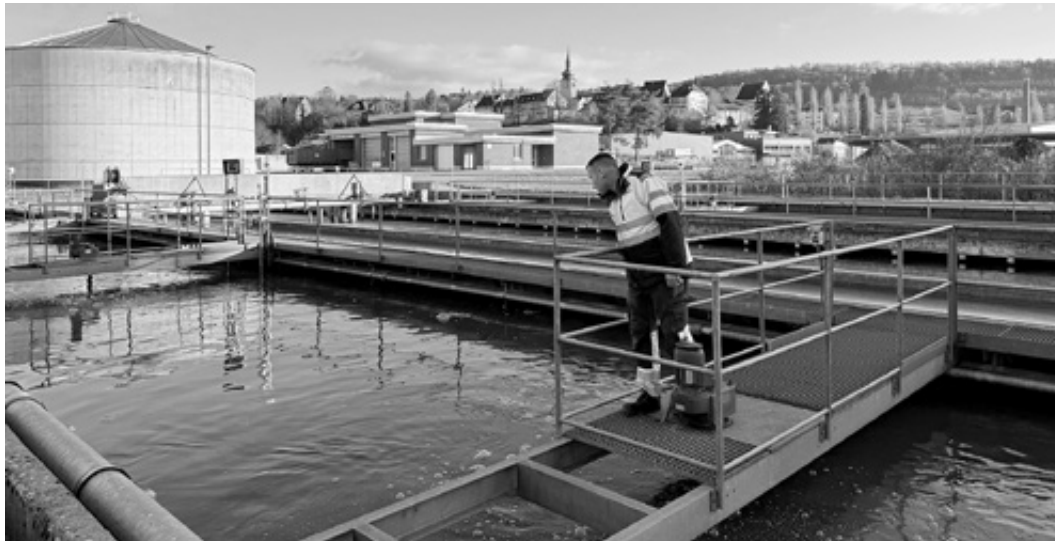
Betriebsleiter Sven Lüthi inspiziert die Kläranlage.
